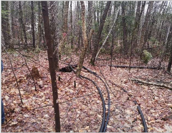
Figure 5 – Conduites vers le manomètre et le régulateur de débit
